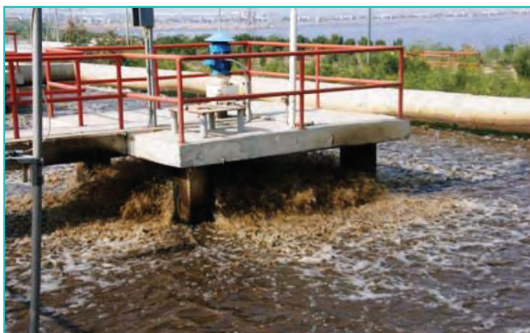
شکل ۵-۶- تصفیه‌خانه فاضلاب ارومیه
