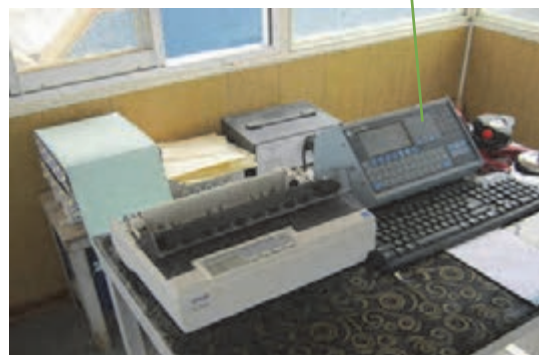
اتاقک کنترل باسکول
