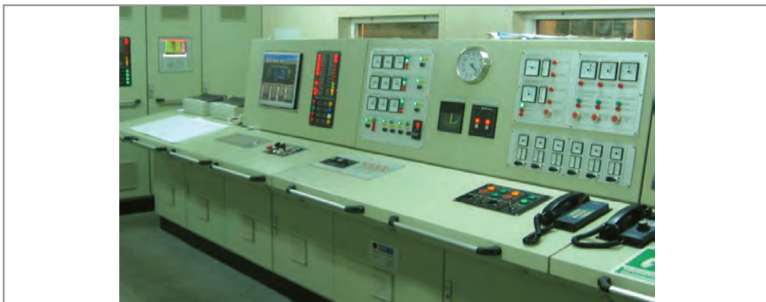
شکل ۴۰ - سامانه هشدار اتاق کنترل موتورخانه
