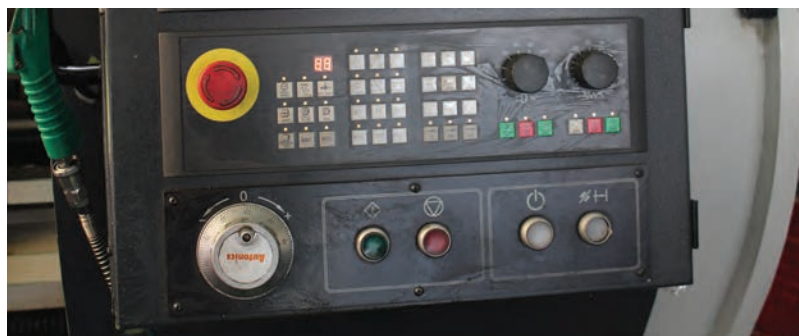
شکل ۱۶- قسمت اپراتوری سیستم کنترل
