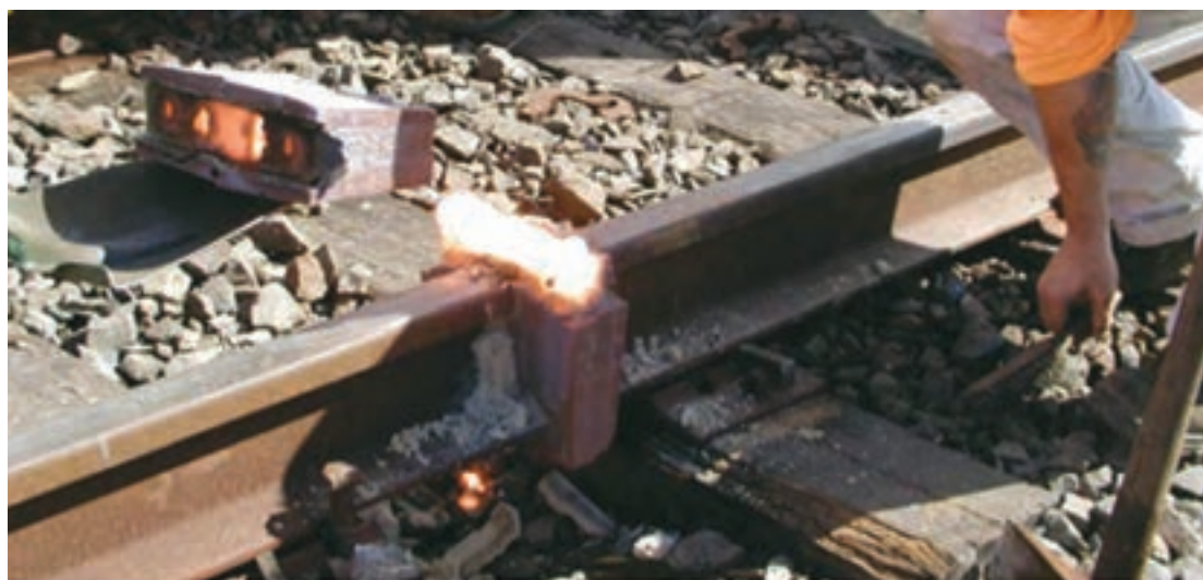
شکل ۲۶- شکستن قسمت فوقانی قالب
