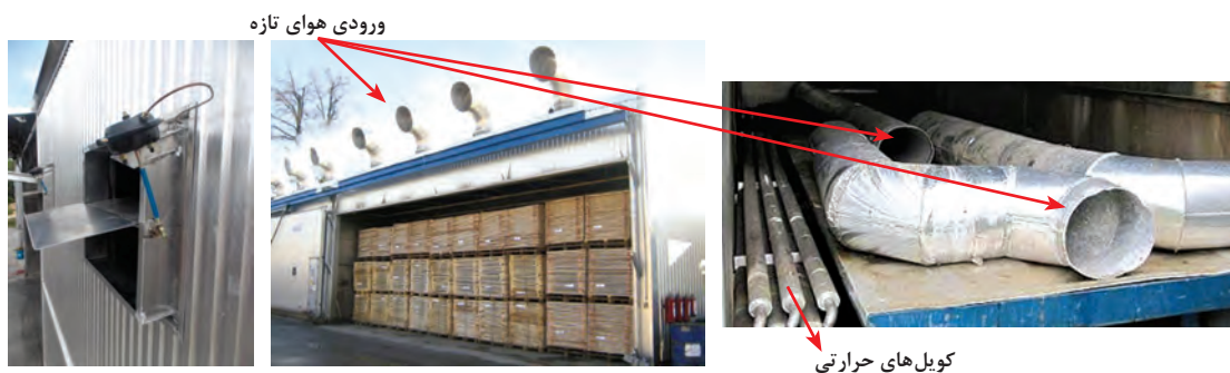
شکل ۴۲- دریچه‌های ورود هوای تازه در قسمت پایین کوره
