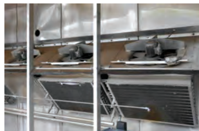
شکل ۴۰- انتقال حرارت کویل‌ها به وسیله فن‌ها
