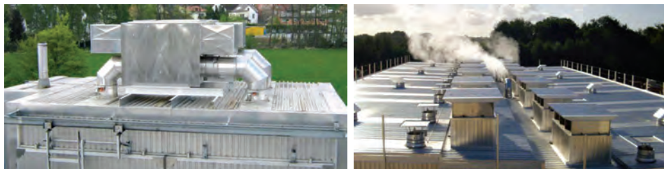
شکل ۶۲- دریچه‌های تخلیه هوا
