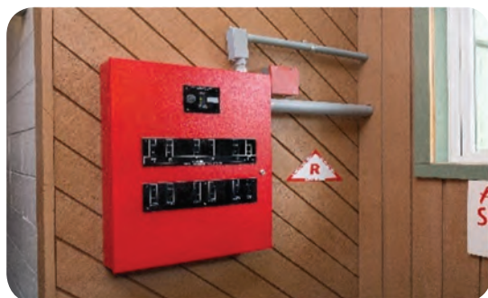
شکل ۳-۴۹- تصویر تابلو کنترل
