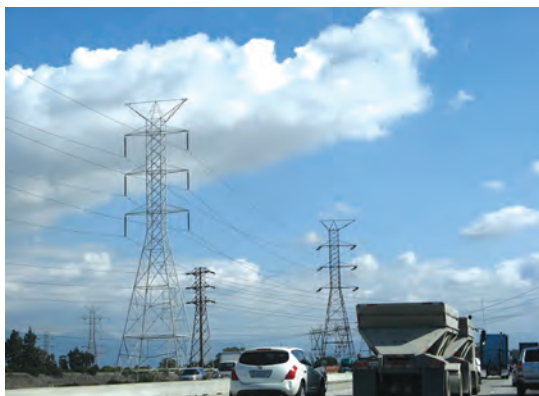
شکل ۳-۵- انتقال انرژی الکتریکی توسط دکل ها
