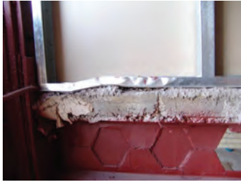
شکل ۷۱-۱- اجرای نامناسب رانر بر روی کف سازه‌ای
