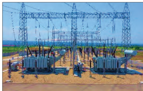
شکل ۳- پست تقویت ولتاژ
