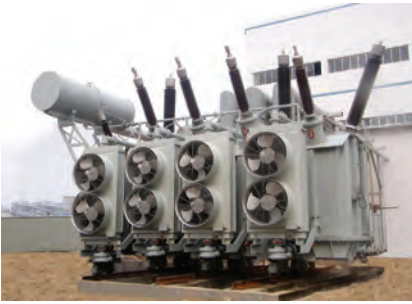
شکل (۳-۱) ترانسفورماتور خطوط انتقال
