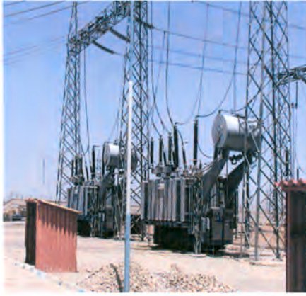
شکل (۲۸-۳) دو ترانسفورماتور موازی شده
