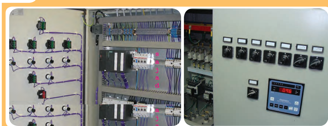
تابلوهای برق صنعتی موجود در کارگاه‌ها
