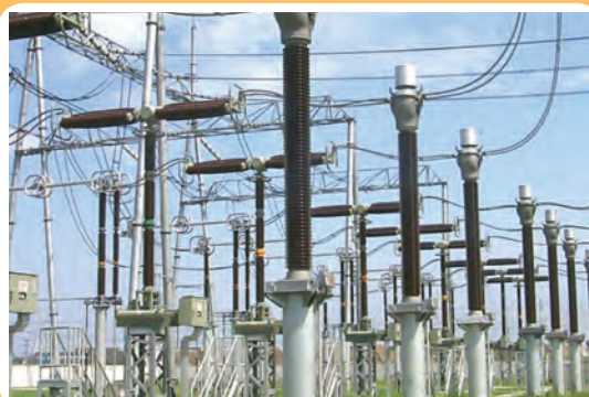
پست تقویت ولتاژ جریان برق
