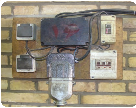
فیش مخصوص اتصال کابل دستگاه جوشکاری به تابلو برق
