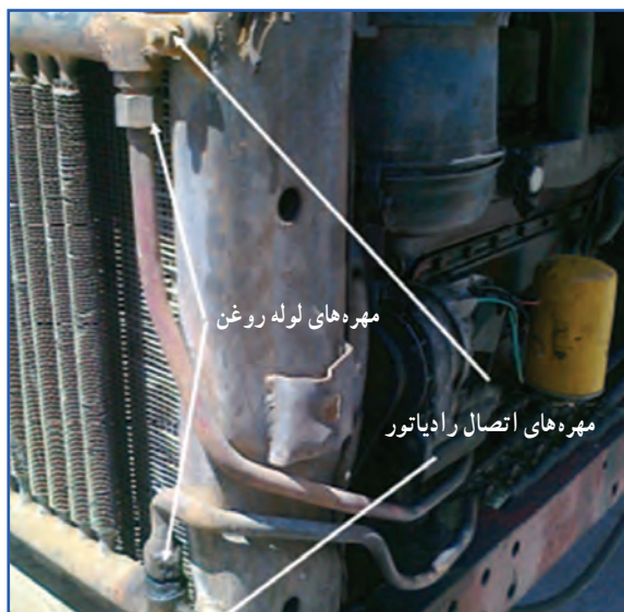
شکل ۳۸-۷- مهره های لوله روغن سمت رادیاتور روغن
