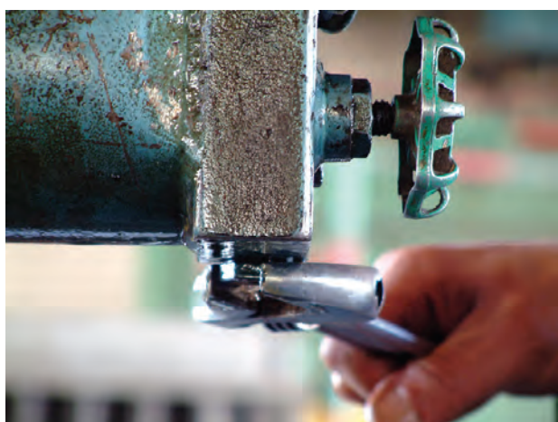
شکل ۱۴-۳- باز کردن درپوش تخلیه ی روغن
