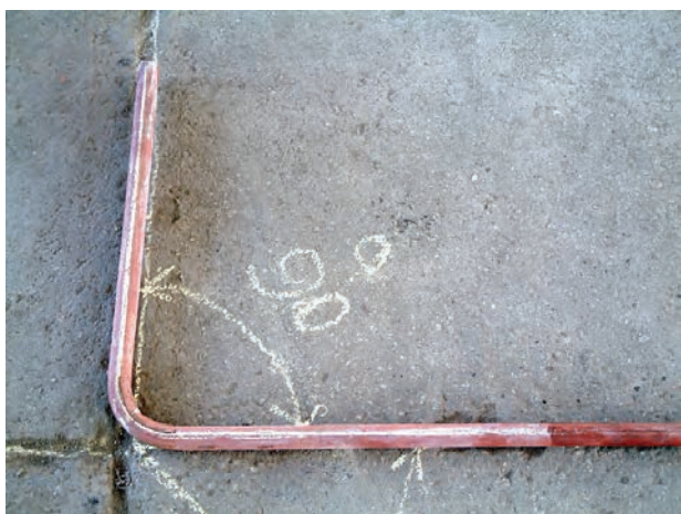
شکل ۳-۵۷- لوله‌ی خم کاری شده
