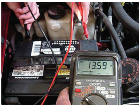
شکل ۱-۵۰ اندازه‌گیری ولتاژ با ولت‌متر دیجیتال
