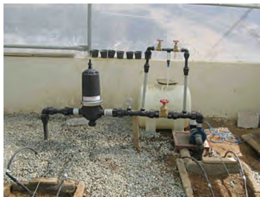
شکل ۱۴- نمونه‌ای از سیستم آبیاری گلخانه
