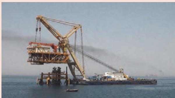
عملیات نصب سکوی فرآورش لایه نفتی پارس جنوبی به وسیله شناور جرثقیل‌دار صدف ۳۰۰۰
