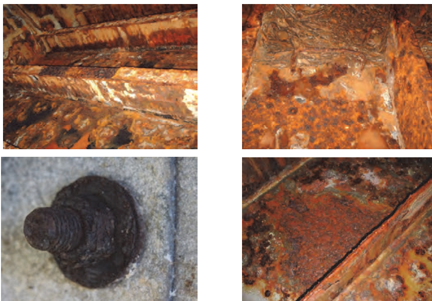
شکل ۱-۱ سطوح زنگ زده در کشتی
