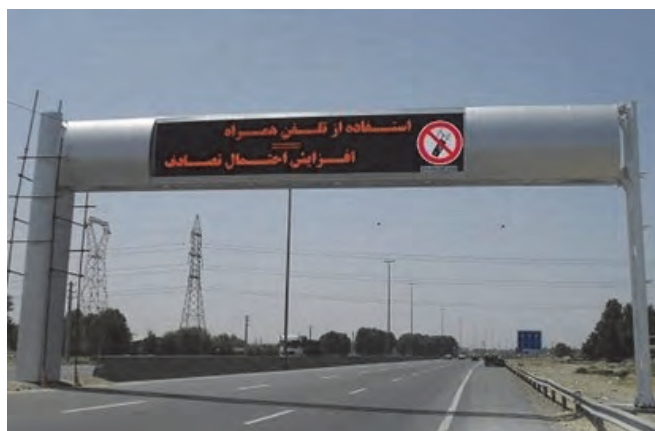
شکل ۱۶- نمایی از تابلوهای پیام متغیر
