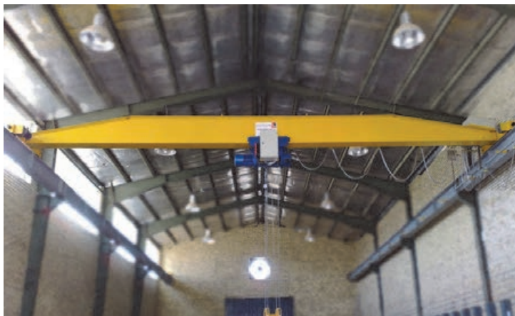
شکل ۲۱- نمایی از جرثقیل سقفی (تک پل)
