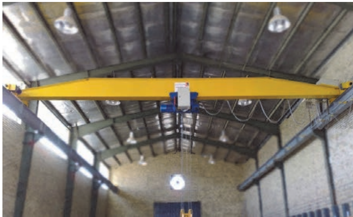
شکل ۲۱- نمایی از جرثقیل سقفی (تک پل)
