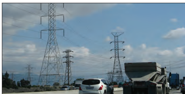
▲ شکل ۱-۵- انتقال انرژی الکتریکی توسط دکل‌ها
