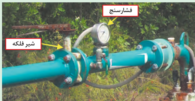
شکل ۲۷-۵. محل شیر فلکه و فشارسنج روی لوله رانش
