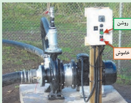
شکل ۲۸-۵. کلیدهای کنترل روی تابلو
