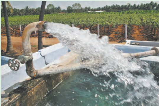
شکل ۳۰-۵. لوله برگشت آب
