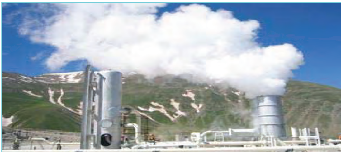
شکل ۲۴-۵- تأسیسات زمین گرمایی مشکین شهر
