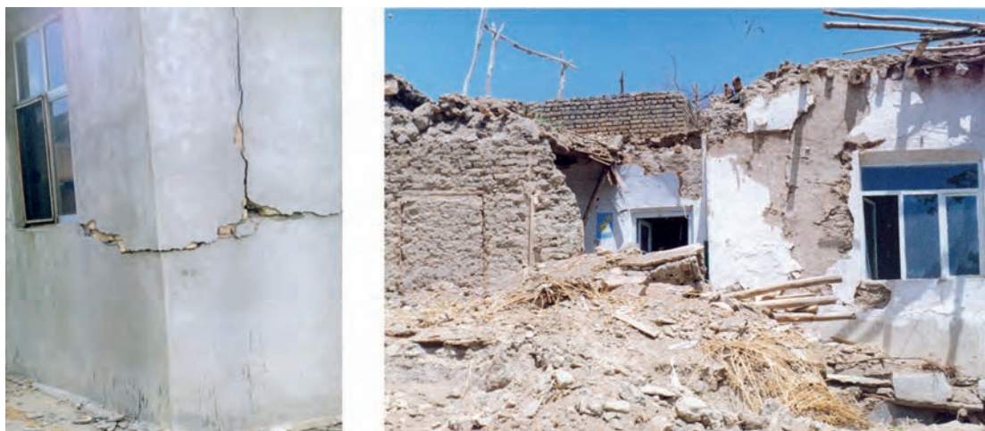
شکل ۳۶-۱- تصاویری از خسارت زلزله اردیبهشت ۱۳۸۱ در دینور
