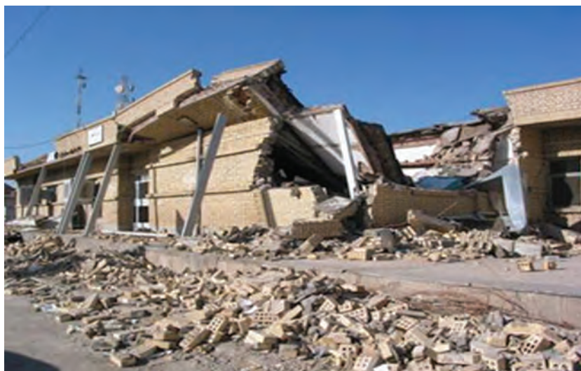
شکل ۱۲-۲- خسارات ناشی از زلزله در استان
