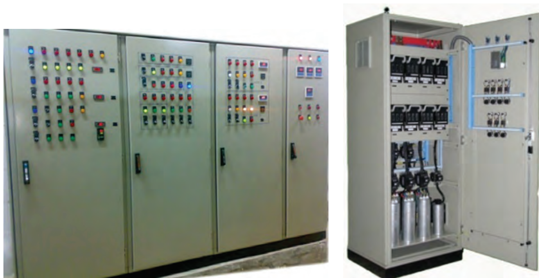
شکل ۱۳- تابلو توزیع برق صنعتی
