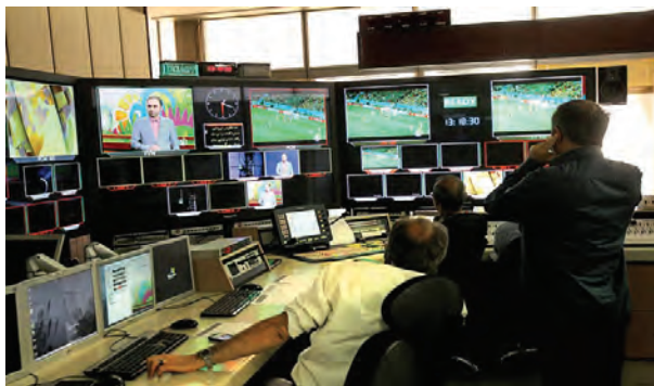
تصویر ۲۹- اتاق فرمان کنترل پخش
