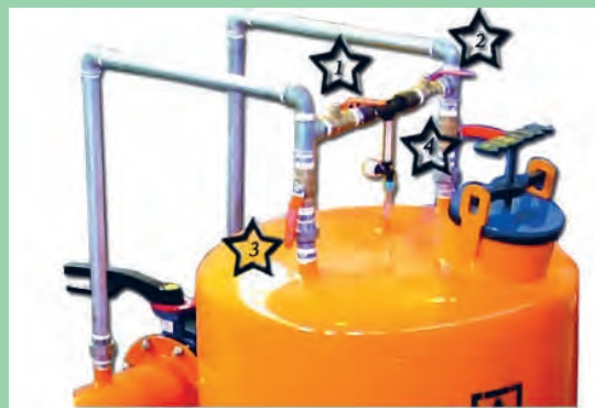
شکل ۳۲- اتصال مخزن کود به لوله اصلی
