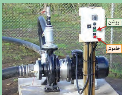
شکل ۱۴- کلیدهای کنترل روی تابلو
