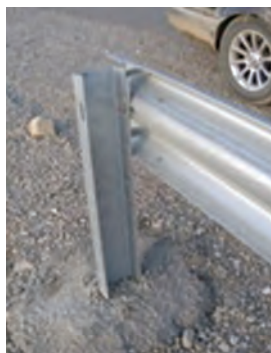
شکل ۶۳- اجرای پایه حفاظ به روش ناصحیح
