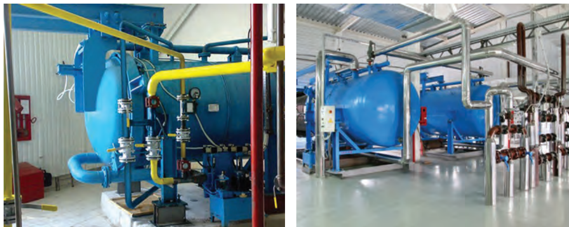
شکل ۱۲- سیستم زمستانه کردن روغن ها
