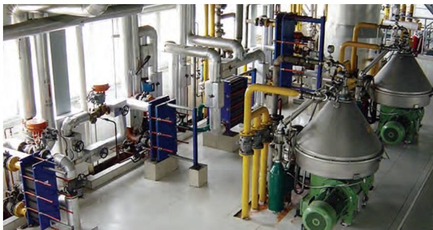
شکل ۶- سیستم خنثی‌سازی مداوم روغن
