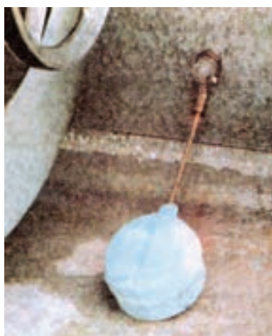
(ب) یک فلوتر نصب شده
