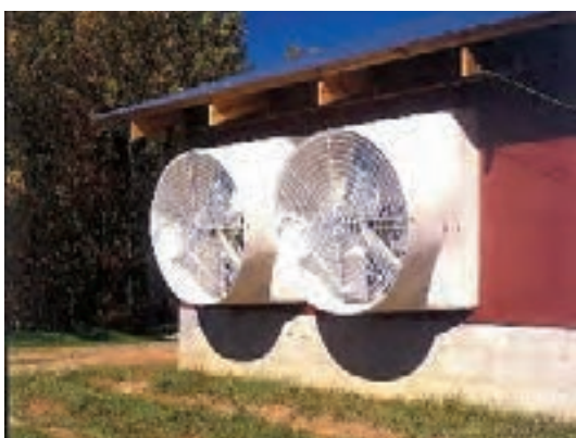
شکل ۱۸-۳- هواکش روی دیوارهای جانبی سالن پرورش طیور
