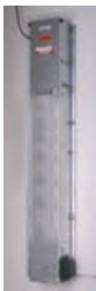
شکل ۲۶-۳- دماسنج کنترل‌کننده پمپ آب
