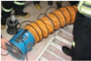
دمنده هوای نصب شده (تهویه با فشار منفی)
