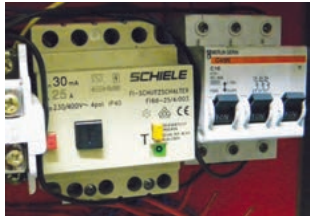
شکل ۲۱-۱- فیوز حفاظتی نصب شده در کارگاه
