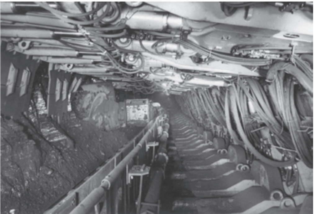
شکل ۹-۲۰- پایه قدرتی در کارگاه استخراج
