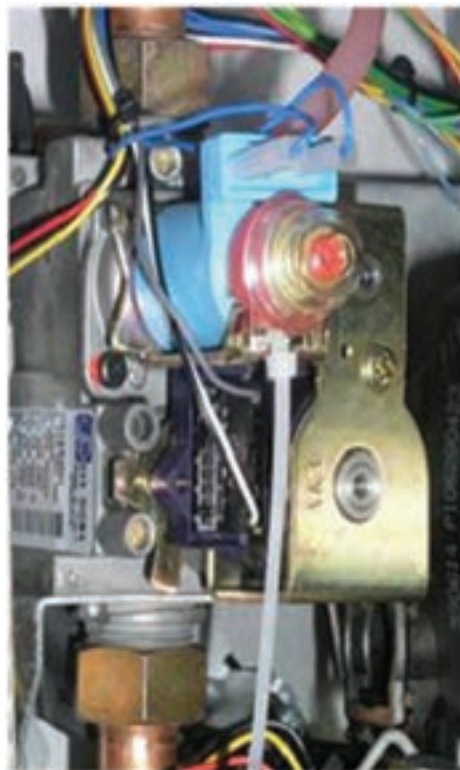
شکل ۱۴-۱۵- شیر کنترلر گاز
