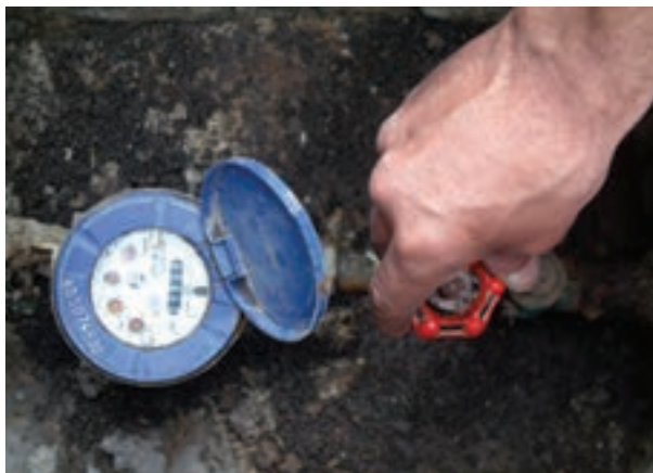
۱- بستن شیر اصلی بعد از کنترل آب
