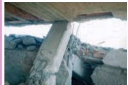
ضعف ستون و عدم اتصال صحیح به تیر بتنی موجب تخریب سازه شده است.
