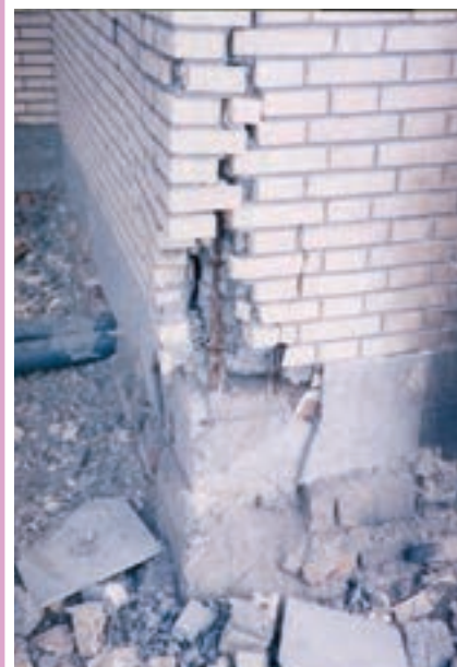
بتن‌ریزی نادرست شناژ قائم
