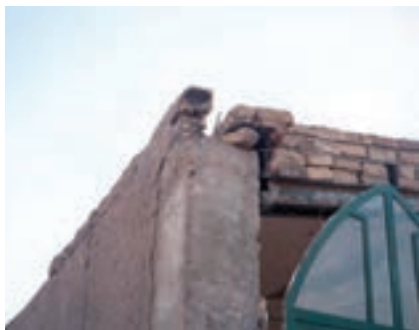
عدم اجرای شنناز افقی بالا و اتصال نادرست تیر
