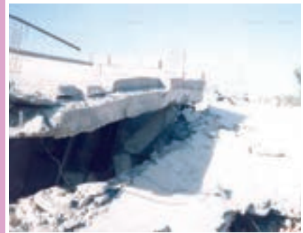
شکست ستون از محل درز اجرایی
