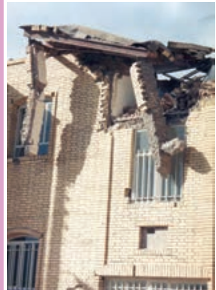
جدا شدن شنازهای قائم خریشته از سازه به دلیل ناکافی بودن طول وصله
