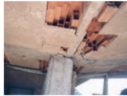
کیفیت نامطلوب بتن در تیر اصلی و عدم اتصال مناسب تیرچه‌ها به آن موجب ریزش سقف شده است.
