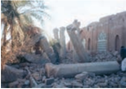
واژگونی ستون در اثر ناکافی بودن سطح آرماتور در پای ستون
