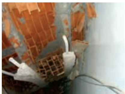
عدم اتصال مناسب تیرچه‌ها با تیر اصلی، موجب جدا شدن آن‌ها از تیر و به تبع آن فرو ریختن سقف شده است.
