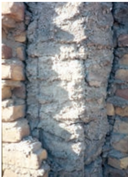
کیفیت نامطلوب بتن موجب تخریب شناژ قائم در این بنای با مصالح بنایی شده است.
