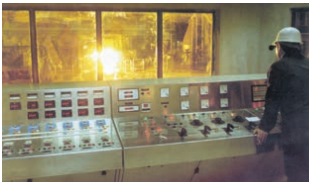
اتاق کنترل نیروگاه برق
