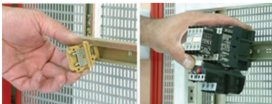
شکل ۶۷-۵- نصب کنتاکتور و ترمینال روی ریل
