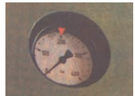
شکل ۲-۵۷ کنترل فشار روغن هیدرولیک
