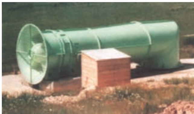
شکل ۲-۲۱- ونتیلاتور جهت تهویه سرچاه
