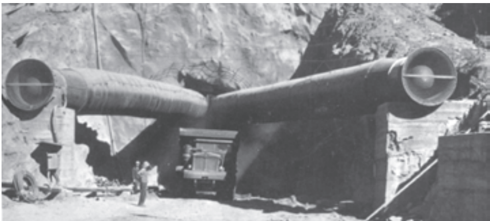
شکل ۳۷-۲- لوله‌های فلزی تهویه با اتصالات جوشکاری شده
