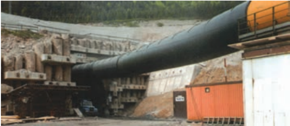
شکل ۳۶-۲- لوله‌های فلزی تهویه با اتصالات جوشکاری شده
