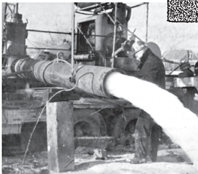
شکل ۵-۶- چاه آب با ظرفیت آب‌دهی ۳۰۰۰ گالن در دقیقه، آب چاه کاملاً صاف و بدون شن است.
