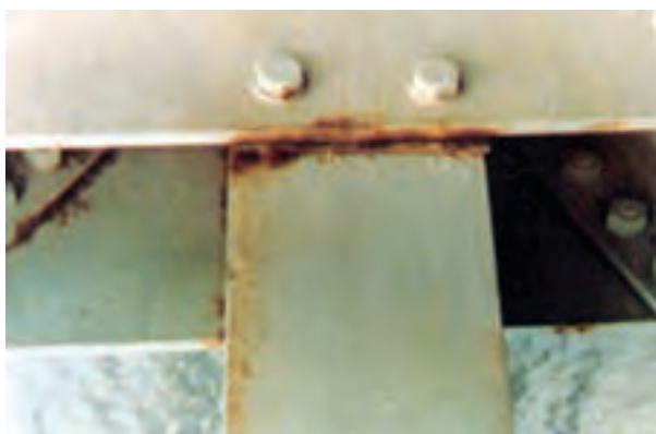
شکل ۶-۴ - آسیب دیدگی در قسمت درزهای محل اتصال
