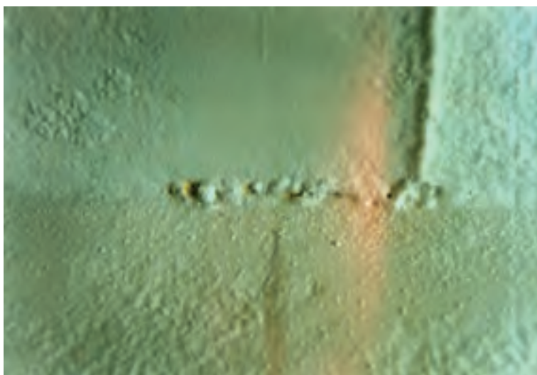
شکل ۶-۳ - جوش کاری و آماده سازی نامناسب
