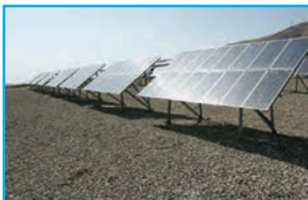
شکل ۱۰-۳ یک نیروگاه فتوولتاییک
