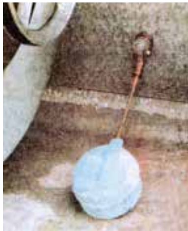
ب) یک فلوتر نصب شده
