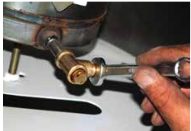
شکل ۶-۱۳- باز کردن مهره‌ی لوله‌ی ارتباطی نفت به کوره
