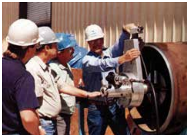
شکل ۷-۴۵- دستگاه برش هیدرولیکی که نوع پخ و زاویه آن را دقیقاً برش می زند.
