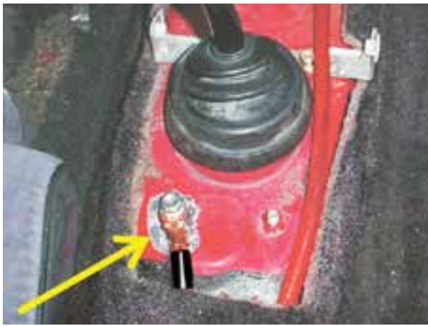
شکل ۲-۲۵- اتصال بدنه‌ی باتری در داخل اتاق خودرو
