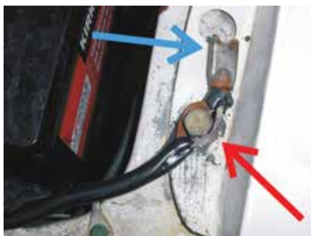
شکل ۳۷-۲- اتصال غلط کابل باتری به بدنه
